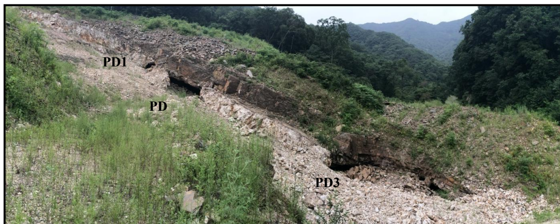
照片 3-4 探矿平硐损毁现状图
